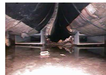
Abbildung 35: stehendes Wasser und blühender Rost an Lager
