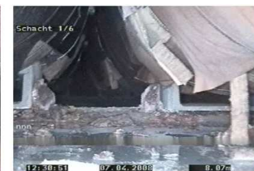
Abbildung 27: stehendes Wasser an Führungslager
