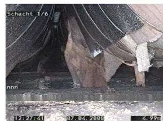
Abbildung 28: im Wasser hängendes Dämmmaterial
