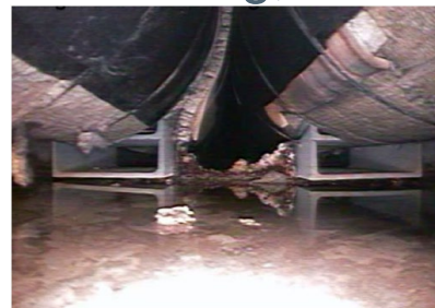
Abbildung 35: stehendes Wasser und blühender Rost an Lager
