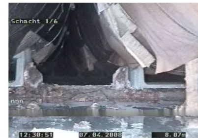
Abbildung 27: stehendes Wasser an Führungslager
